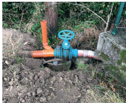
Viehausen: Zuleitung zum Löschteich
